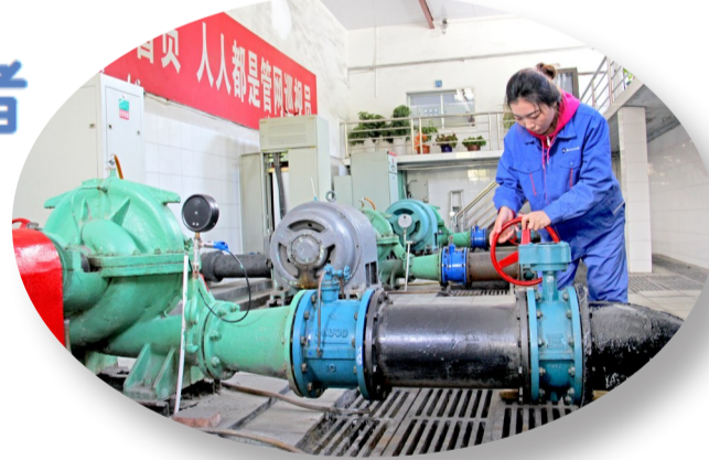
国庆假期，供水分公司加压站女工检查水泵运行情况。
