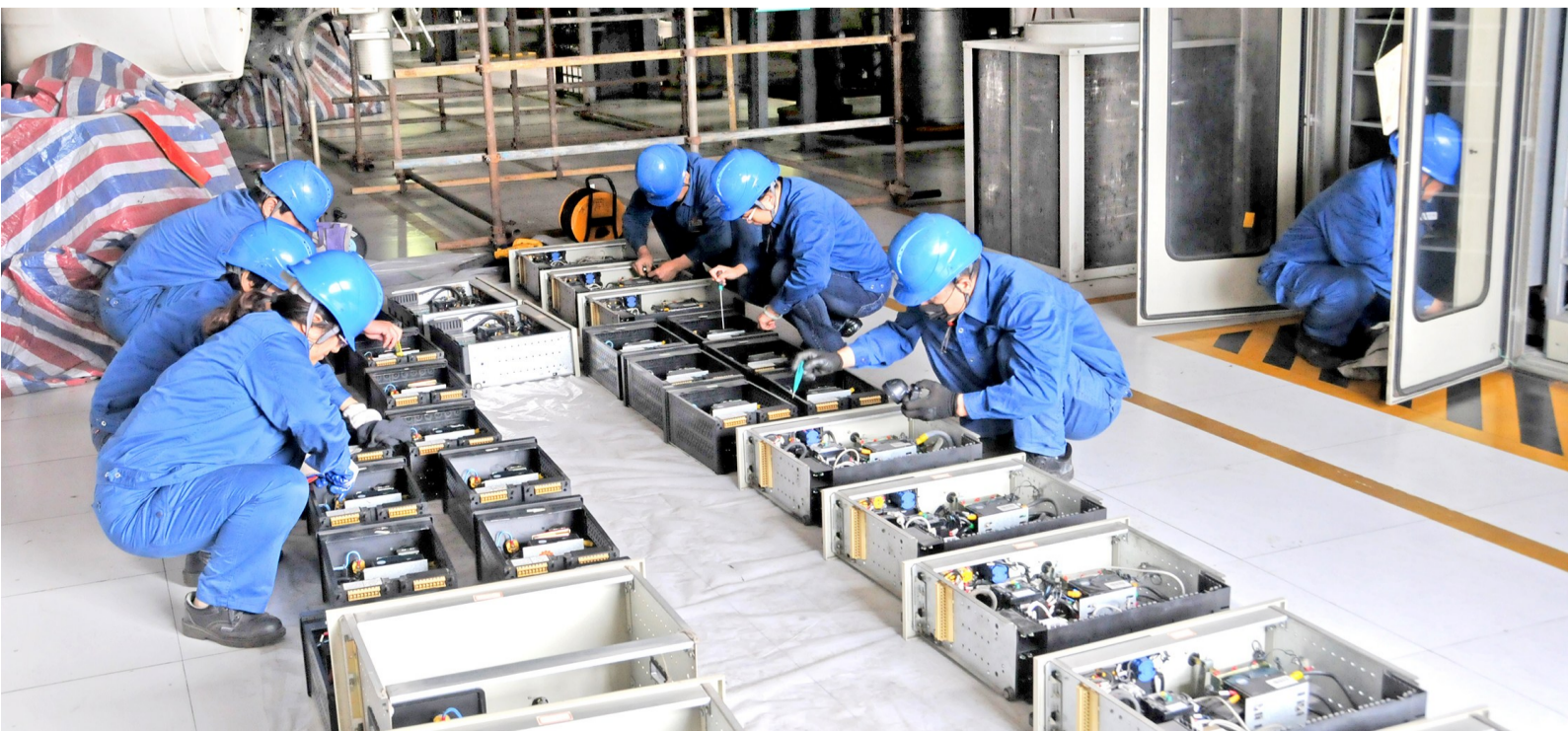
国庆假期，漳电临汾热电公司维检人员坚守一线，丝毫没有因为节日，影响检修作业的进度。图为设备维护部低压组人员对设备及所有负荷开关进行清扫检查，确保设备安全运行的可靠性。
