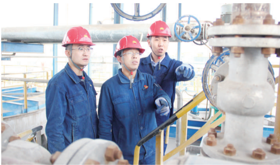
催化剂厂原料车间员工对分子筛储罐进行检查,确保不冻坏一条管线、一台设备、一个阀门。(李发龙)
