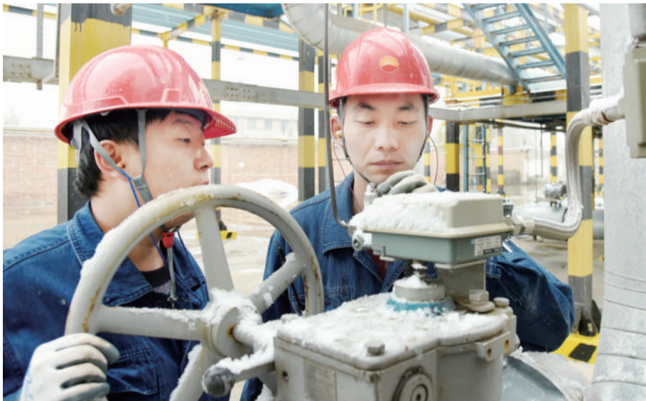
动力厂组织员工第一时间清除装置及巡检路线的积雪,对关键岗位、重点设备进行不间断巡检,抓好装置机泵、仪表、管线、阀门的防冻工作。(邵国轩)
