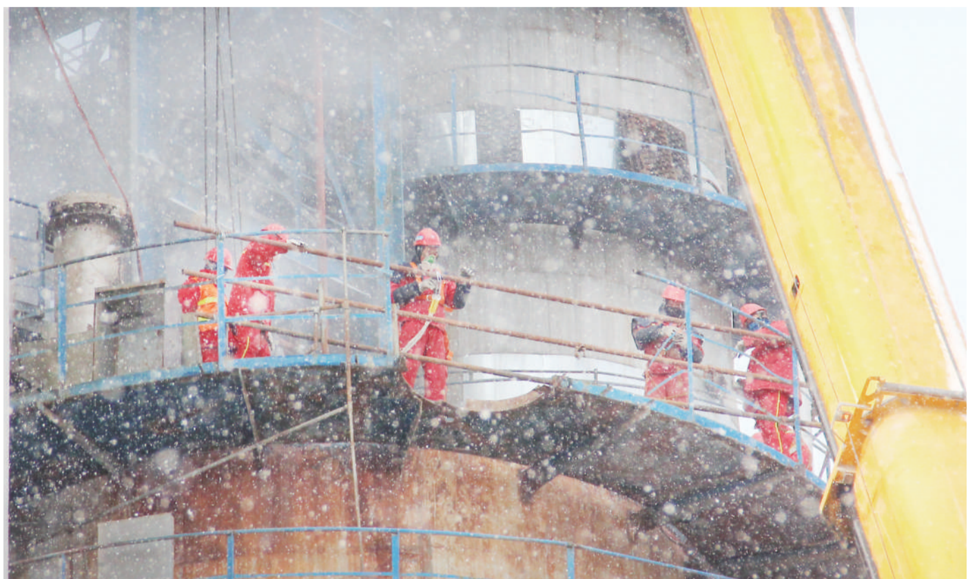
建设公司的员工顶着风雪在炼油厂催化一联合车间检修现场进行作业。(李发龙)
