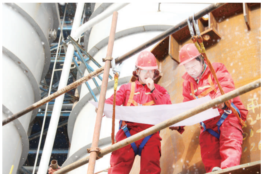
雪天下,建设公司员工正在核对预制的设备数据,确保设备焊接制作合格,保证施工质量。(李发龙)
