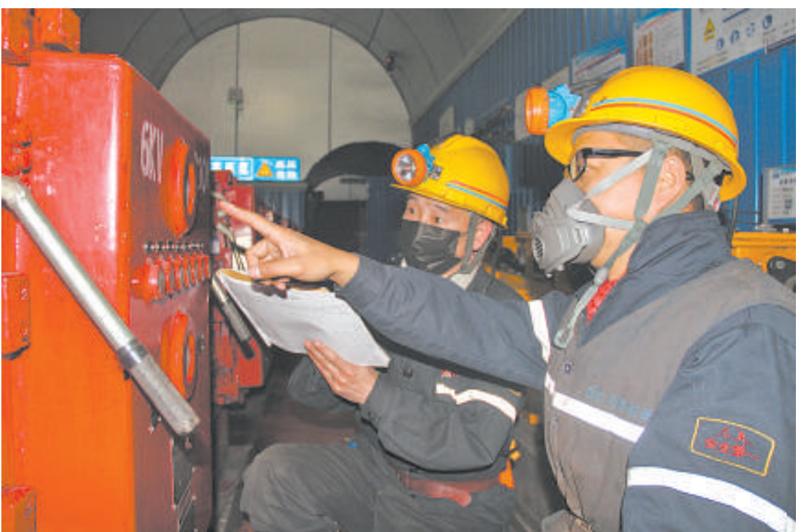
耿村煤矿认真做好疫情期间安全生产管理工作,强化机电设备正常保养和检修,保证机电设备安全运行,确保疫情期间矿井安全生产。图为3月15日,该矿机电技术人员正在对变电所机电设备运行参数进行分析、统计、总结。
