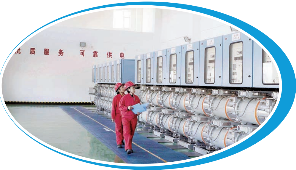
← 组建操作队,每周对变电站进行巡视,确保电力安全运行。
